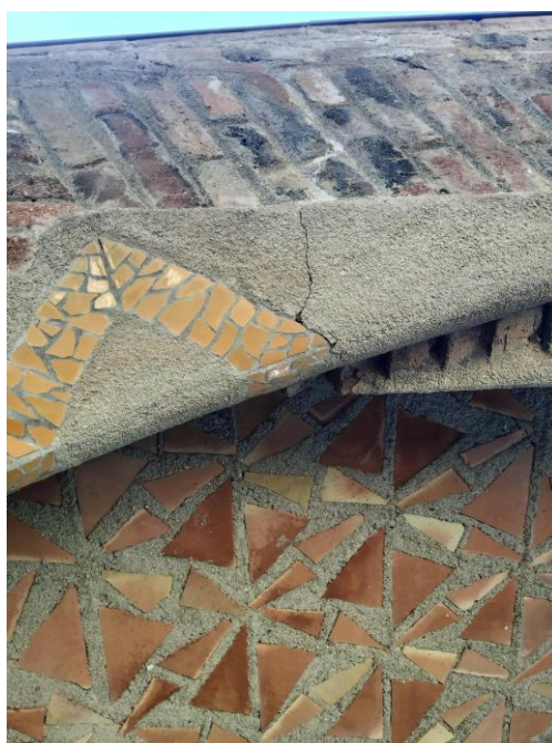
Imatge d'una de les fissures del porxo d'accés a la Cripta.
