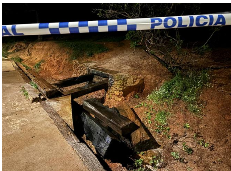
Imatge dels restes de les travesses de fusta de la passarel·la cremada
